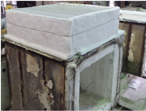
写真 3.1 加熱炉の状況
