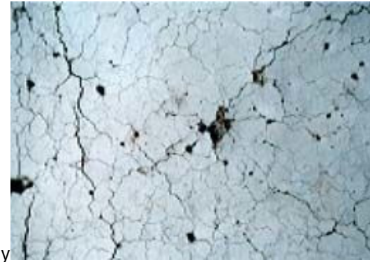
写真 1.4 RC 造構造物部材の被害
