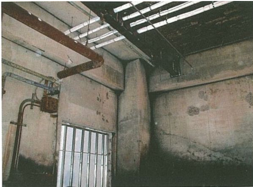
写真 1.1 RC 造構造物部材の被害
