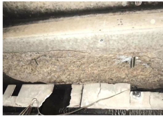
写真 1.2 RC 造構造物部材の被害
