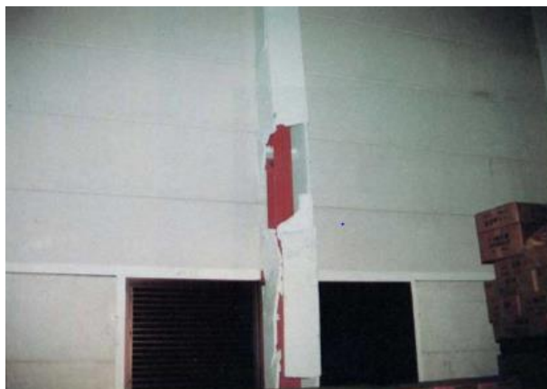
Fig. 1.5.1 倉庫内の耐火被覆柱の損傷 [1.14]
