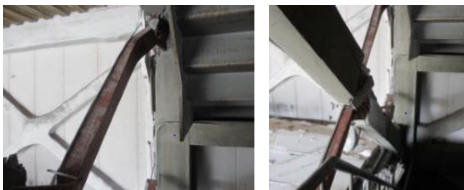
a) ブレースの座屈
