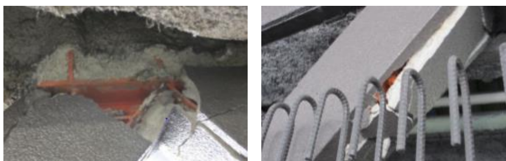
a) 剥がれた耐火被覆
