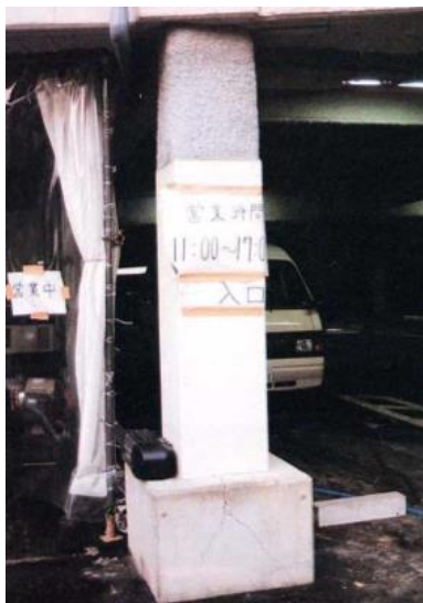
Fig. 1.5.2 コンクリート柱のひび割れ [1.14]
