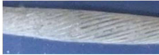
図 2.1.6 アルミ線の腐食状況
