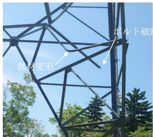
図 5.2.1 冠雪による部材損傷
