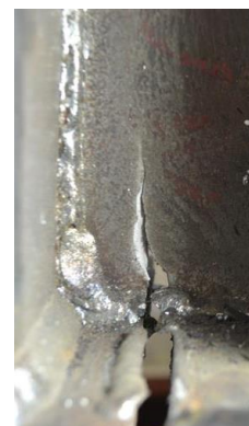
溶接部の破断
