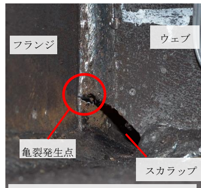
スカラップ底を起点とした亀裂
