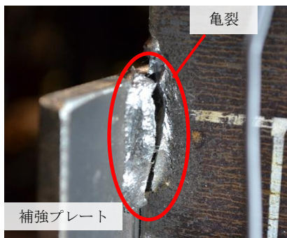
プレート溶接部の亀裂
