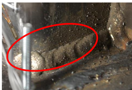
パネルとダイアフラムの 溶接部の軽微な亀裂
