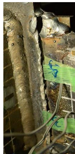
溶接部の破断
