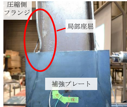
圧縮側フランジの局部座屈
