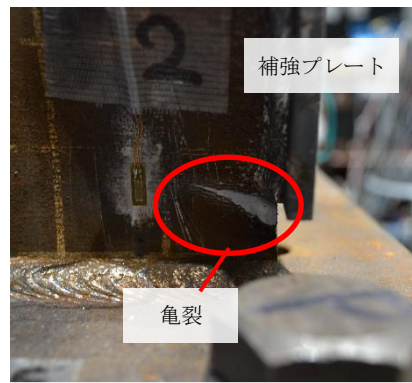
フランジ端部の亀裂
