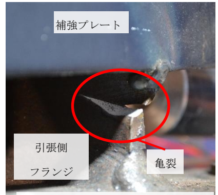
フランジ端部の亀裂
