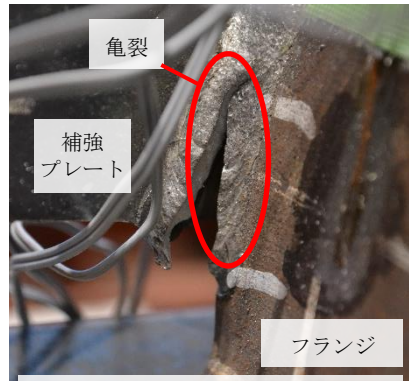
プレート溶接部の亀裂
