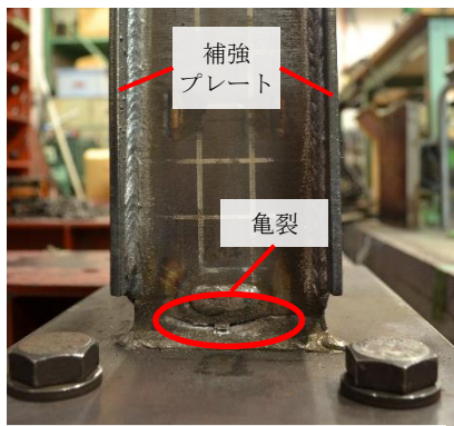
亀裂補修部に再度生じた亀裂
