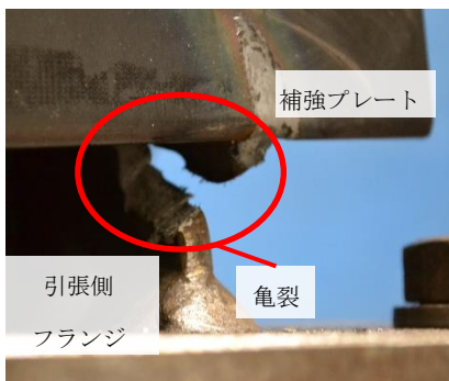
フランジ端部の亀裂
