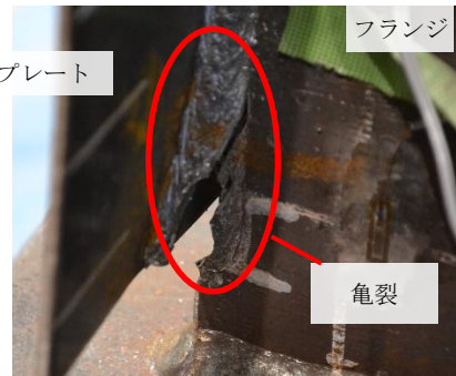
プレート溶接部の亀裂
